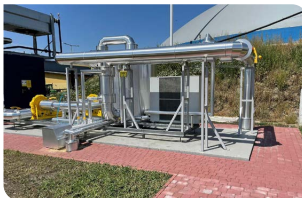
Zdjęcie 2. Oprzyrządowanie biogazowe – stacja uzdatniania biogazu, SJ Construction
