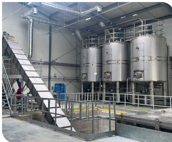
Zdjęcie 1. Linia do pasteryzacji odpadów biodegradowalnych o wydajności do 100 t/dobę, SJ Construction
